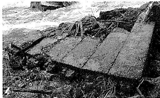
写真4 石徹白橋(左岸側径間)の橋桁片
