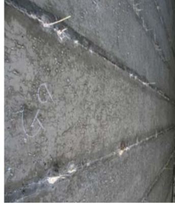
ASRゲルの滲出
