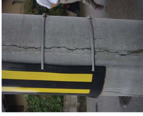
PCa電柱のASRIによるひび割れ(FAコンクリートの標準化(H28)) 10 (ASRR抑制対策後にASRR発生(今でも), 金沢市内(全国で発生))
