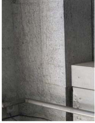
PC鋼材に沿ったひび割れ 桁端部での膨張変形
