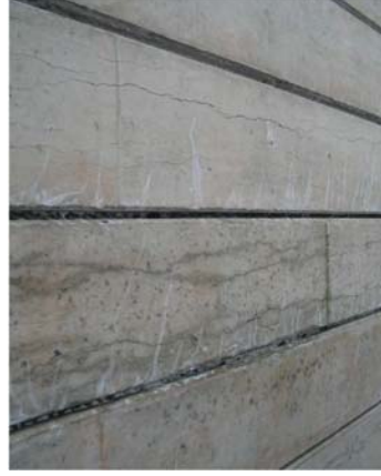
橋軸方向のひび割れ
