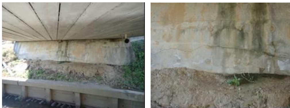
写真 2 橋台がひび割れた道路橋の例
