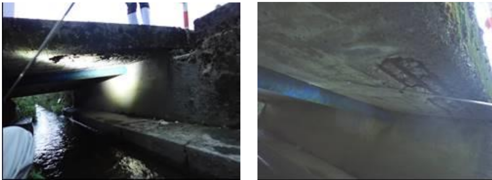
写真 1 上部工コンクリートが剥落した道路橋の例
