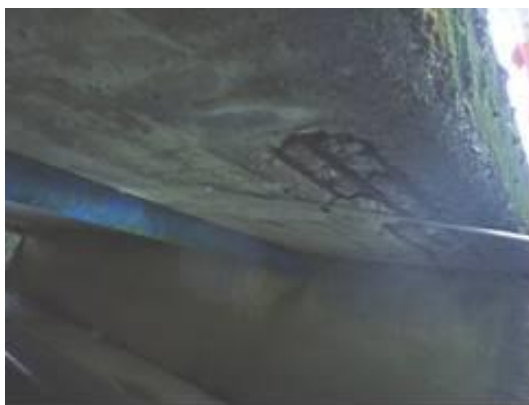
写真 1 上部工コンクリートの剥落部
