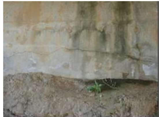
写真 2 橋台のひび割れ部
