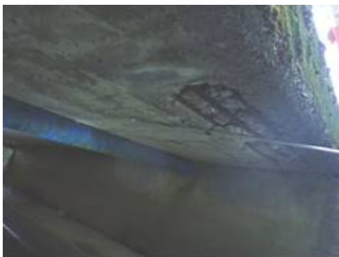
写真1 上部工コンクリートの剥落部
