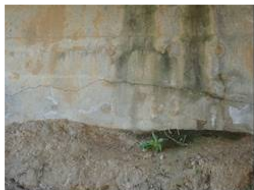
写真2 橋台のひび割れ部
